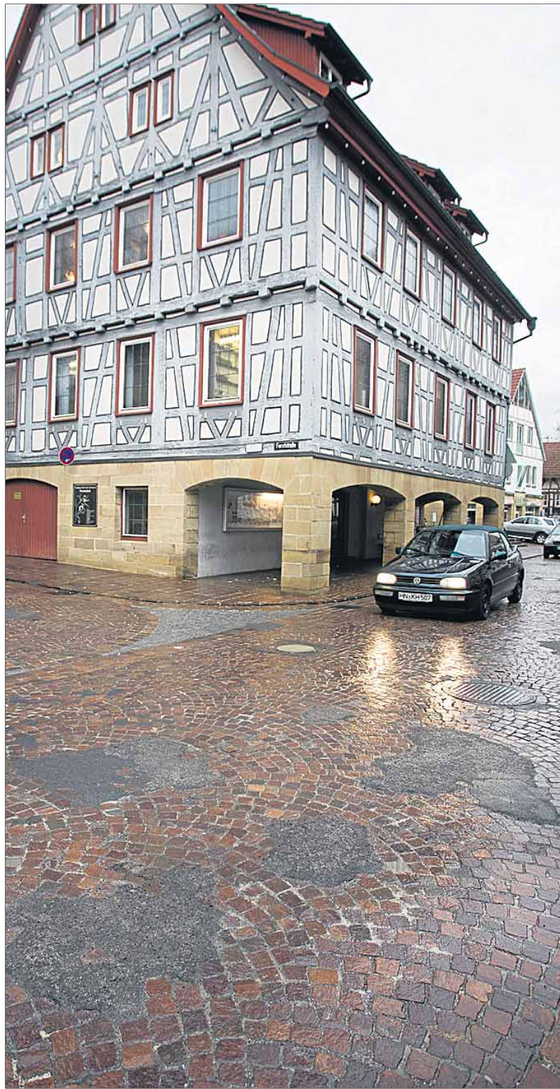
Wacklige Steine werden mit Asphalt verfüllt. Bild: Holm Wolschendorf
